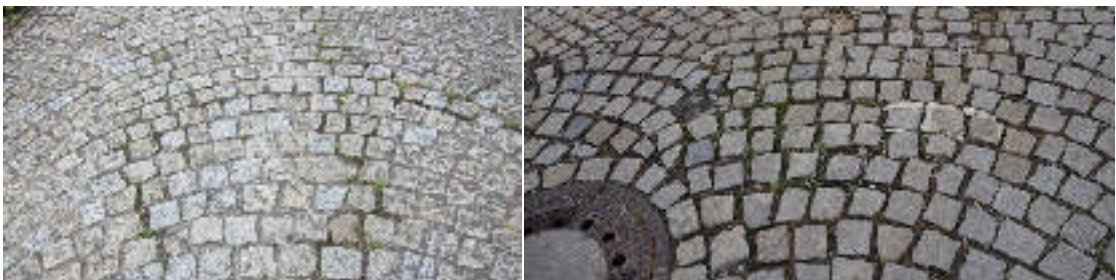
Sanierte Ortsdurchfahrt mit baulichen Mängeln im Gehwegbereich
