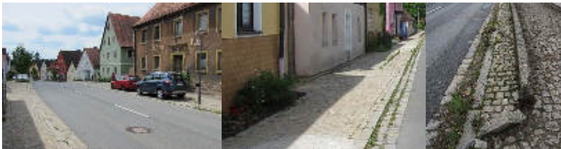
Sanierte Ortsdurchfahrt mit Pflegedefiziten und Schäden in der Unteren Hindenburgstraße.
