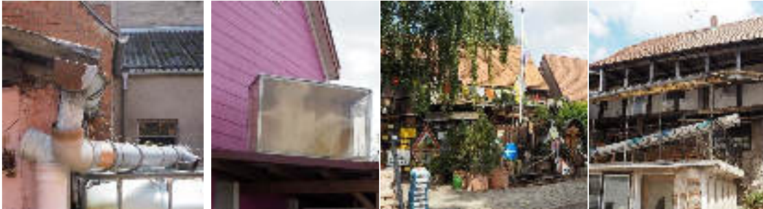
Gestalterisch unbefriedigende Elemente und Situationen mit negativen Auswirkungen auf das Ortsbild.
